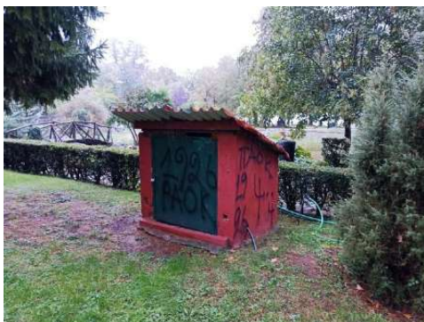
Φωτογραφία υφιστάμενου αντλιοστασίου
